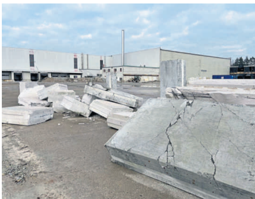
Ein Teil der ATU-Hallen ist abgerissen. Auf einem Großteil der Freiflächen soll bald Leergut gelagert werden.
